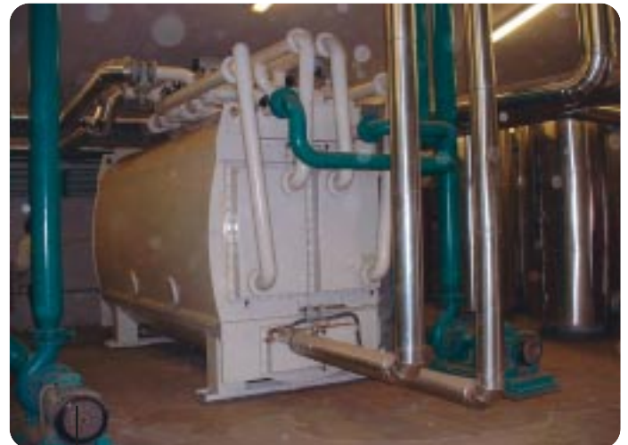
Abbildung 14 Adsorptionskältemaschine - Sarantis - Griechenland
