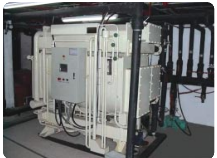
Abbildung 12 Absorptionskältemaschine - Rethimno Village Hotel, Kreta
