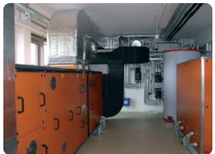
Abbildung 16 DEC-Anlage mit flüssigem Trockenmittel im "Solar Building Innovation Center" (SOBIC) in Freiburg (D)
