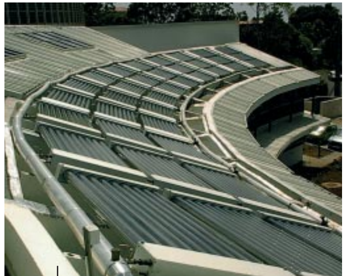
Abbildung 18 Sonnenkollektor auf dem Dach von DIREN (Guadeloupe, Frankreich)
